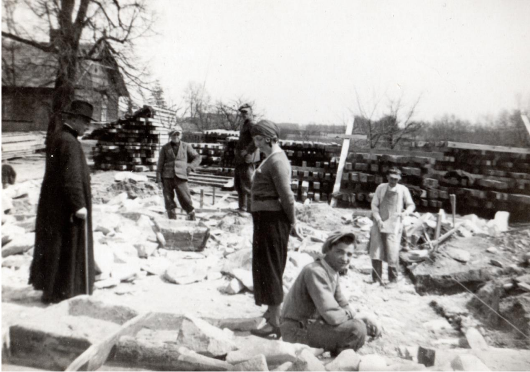
Il. 75. Prace przy fundamentach nowego kościoła w Kaniem, po lewej stoi ks. W. Gosek, w tle widoczna stara plebania i zgromadzone materiały budowlane (fot. z archiwum G. Wojciechowskiego)
