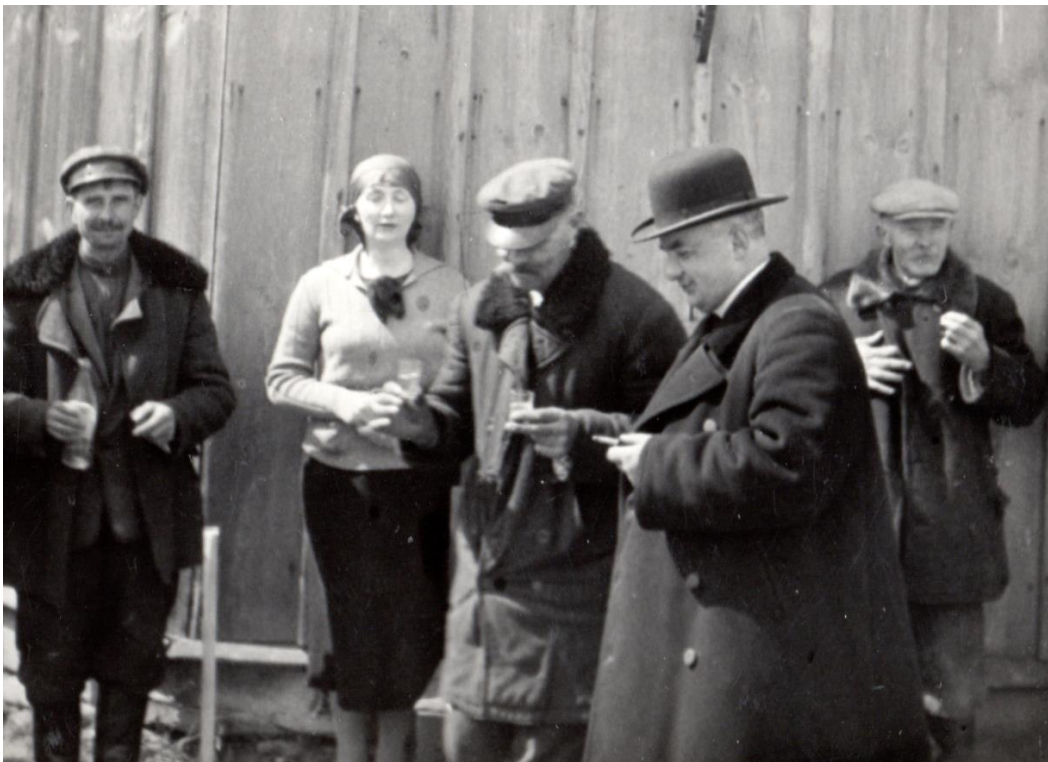
Il. 78. Krótka przerwa w pracy w trakcie budowy fundamentów nowego kościoła w Kaniem, drugi od prawej ks. W. Gosek, w tle tylna ściana prezbiterium starego kościoła (fot. z archiwum G. Wojciechowskiego)
